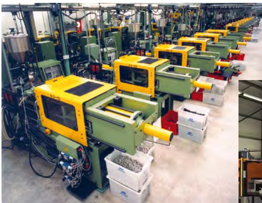
Linea di stampaggio ad iniezione installata su zoccoli Isoshock
