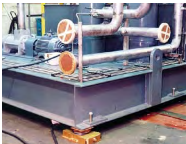
Gruppo di pompaggio, installato sopra livellatori di precisione a cuneo (LF)
